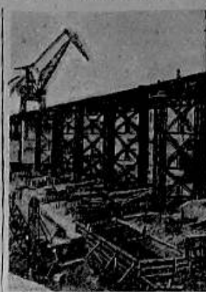
На строительстве Новосибирской гидроэлектростанции. На снимке: общий вид работ и котлован под здание ГЭС.
