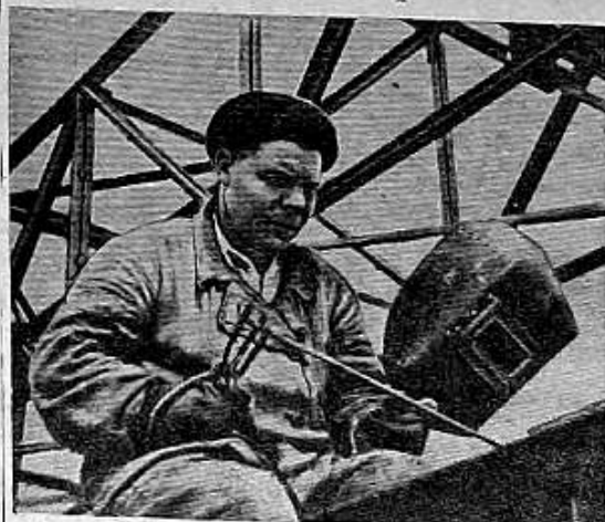
Недавно на Загорском лакокрасочном заводе закончен монтаж эстакады трубопровода, который должен соединить лакокрасочный цех с цехом сырья. Сейчас ведется монтаж трубопровода. В скором времени сырье пойдет по трубам в лакокрасочные аппараты.
