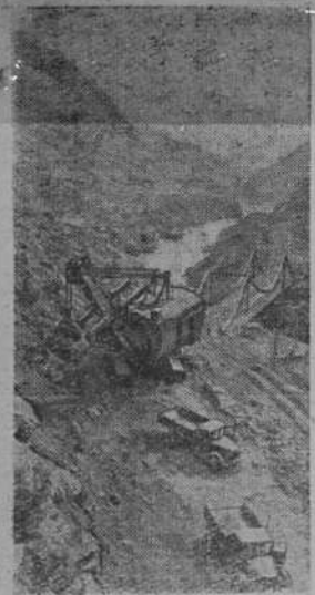
Этот снимок сделан на строительстве Нурекской ГЭС в Таджикистане. Скальный экскаватор прокладывает дорогу для отсыпки первой очереди плотины. Фотохроника ТАСС.
