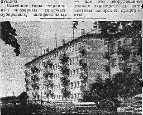
Новый жилой дом достраивает в Хотковском районе Загорска УКС электротехнического завода. Фото П. Красноя.
